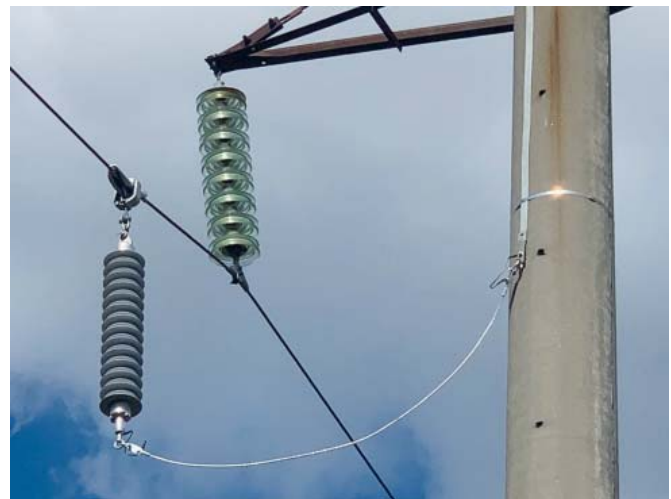
Рис. 5. Установка подвесных ОПН-110 на железобетонных опорах одноцепной ВЛ 110 кВ на противоположном нижнем проводе
