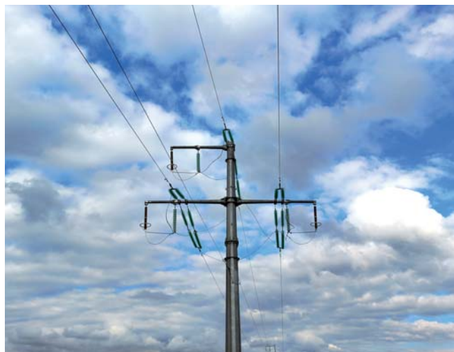
Рис. 1. Линейные ОПН на ВЛ 220 кВ Волга — Заливская
