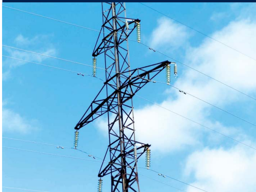
Рис. 9. Линейные разрядники типа РВА производства НПО «Полимер-Аппарат» на ВЛ 110 кВ Алёхинского — Ай-Пимского месторождений
