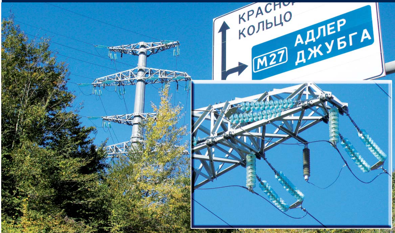
Рис. 7. ОПН на траверсе опоры ВЛ 110 кВ Сочинская ТЭС — ПС «Сочи»
