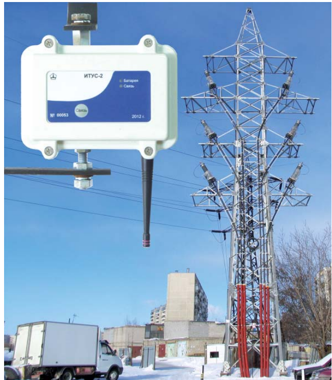
Рис. 2. Новая опора с ОПН-110 в г. Челябинске с приборами контроля ИТУС-2 ЗАО «Полимер-Аппарат» на кабельных вводах
